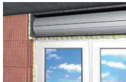
Швы в месте крепления оконных жалюзи
