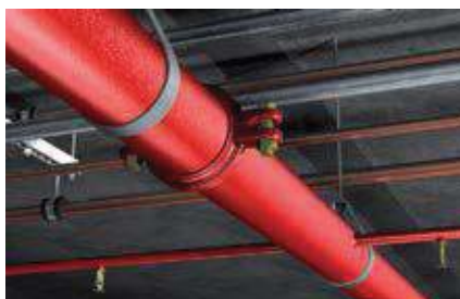
Системы аварийного пожаротушения
