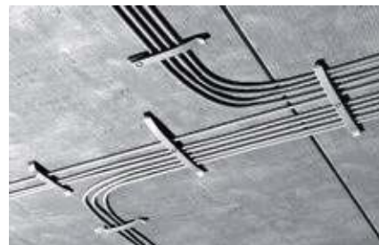
Крепление кабельных линий
