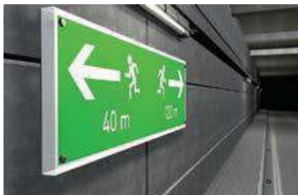
Знаки аварийного выхода в туннелях
