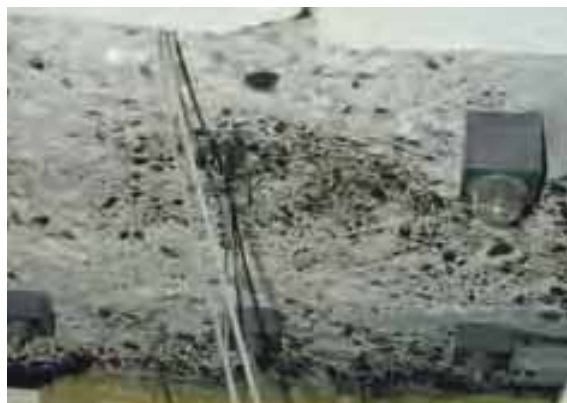
Рисунок 6.10: Откалывание поверхностного бетонного слоя /2/
